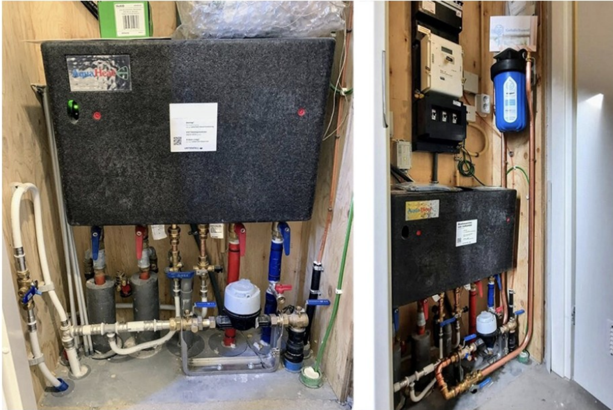
De warmtewisselaar in de meterkast
