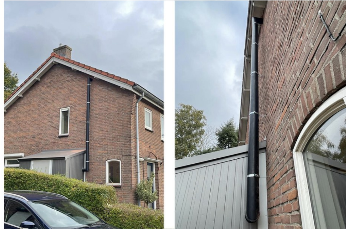
Aan- en afvoerleiding naar zolder
